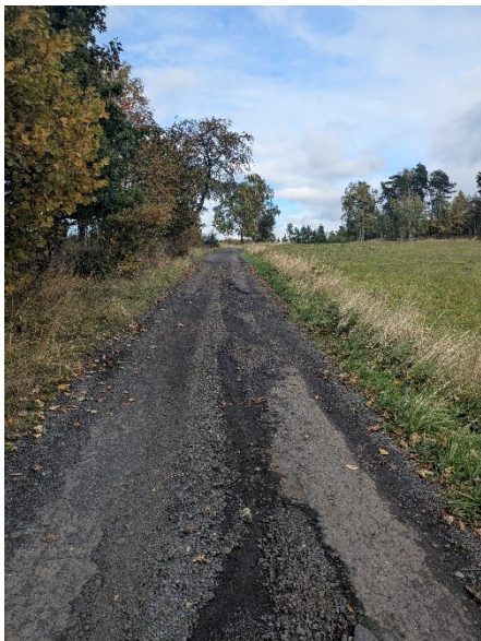
Oprava komunikace Křemenitá – před rekonstrukcí
